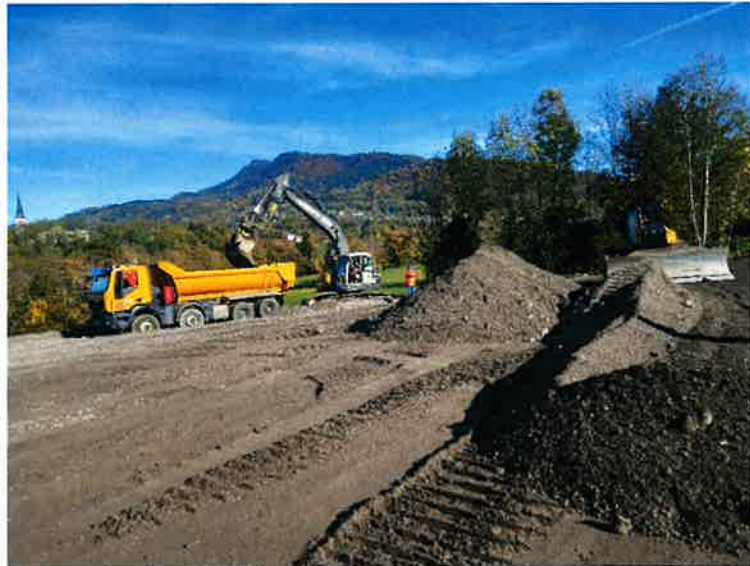
Mise en œuvre de mâchefers sur un chantier routier du département de la Haute-savoie à Fillinges.
